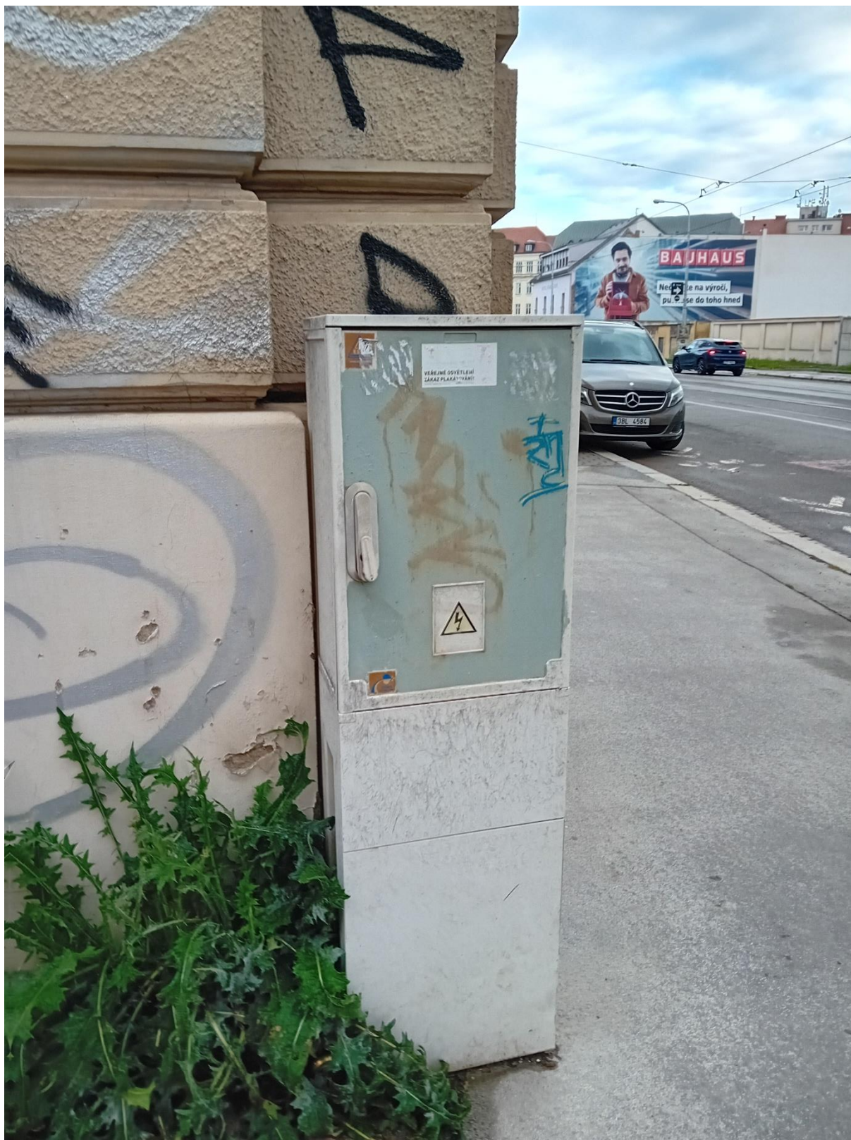
Pohled na rozpínací skříň ve vlastnictví spol. Technické sítě Brno
