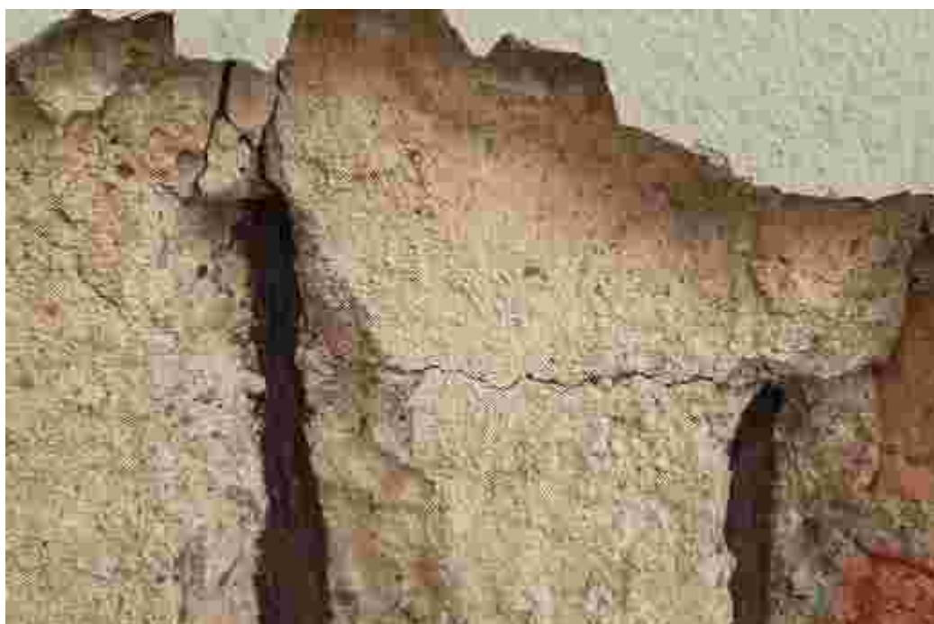
Obr.67: Detail korodované výztuže z předchozího obrázku.
