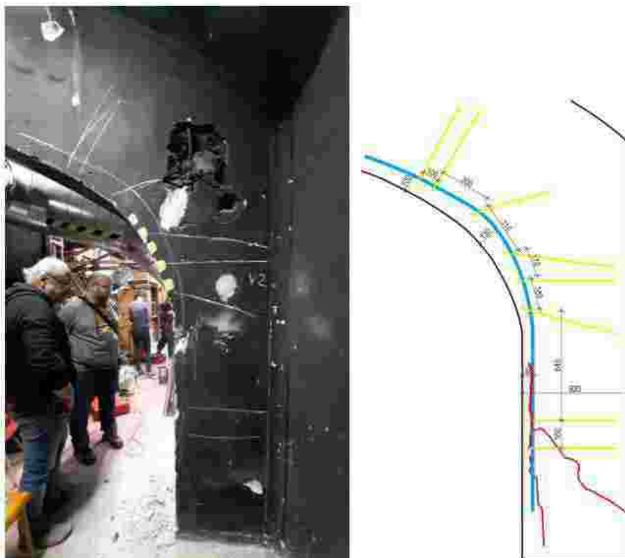
Obr.20 : Celkový pohled na místo sondy S5J spolu s vykreslením polohy trhlin a výztuže opět jasně ukazuje, že průběh trhliny souvisí se způsobem vyztužení, a velkou roli hraje poloha třmínků ve sloupu, která trhlinu zde posunula níže k úrovni podlahy osvětlovací galerie.
