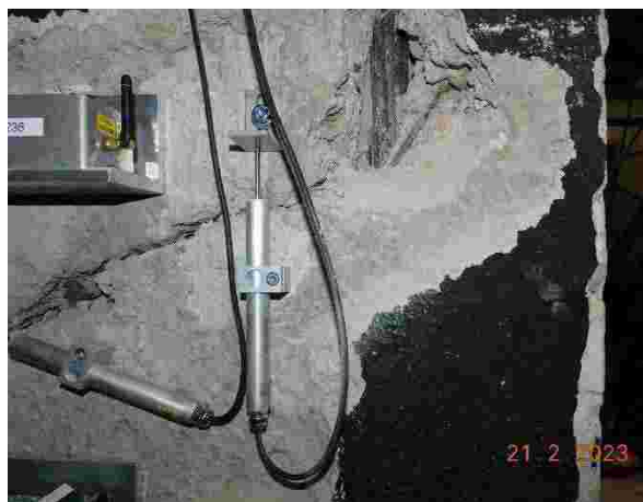
Foto z instalace 21.2.2023, detail snímače DH15
