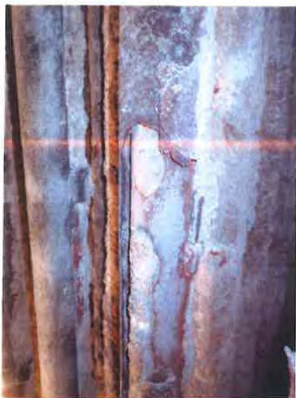
Obr. 1.2-5 – Trubky trubkového svazku P4100202 –
