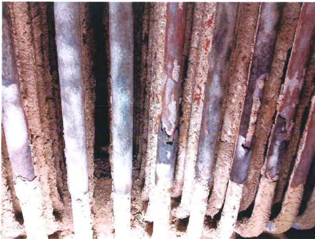
Trubky výparníku s poškozenými chráničkami
