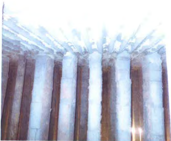
Obr. 1.1-1 – Strop spalovací komory P4100017 –
