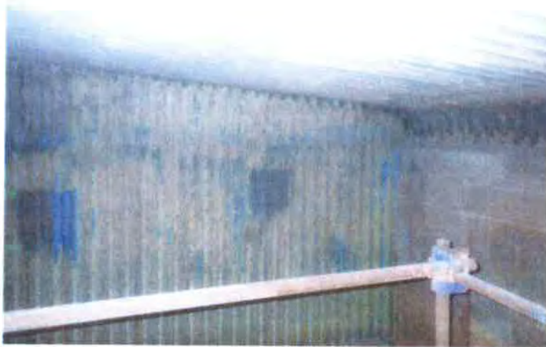
Obr. 1.1-2 – Horní část spalovací komory P4100019 –
