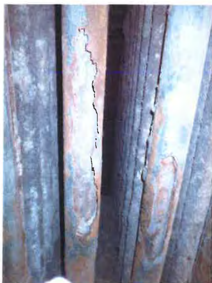
Obr. 2.2-4 – Trubky trubkového svazku P4160049 –
