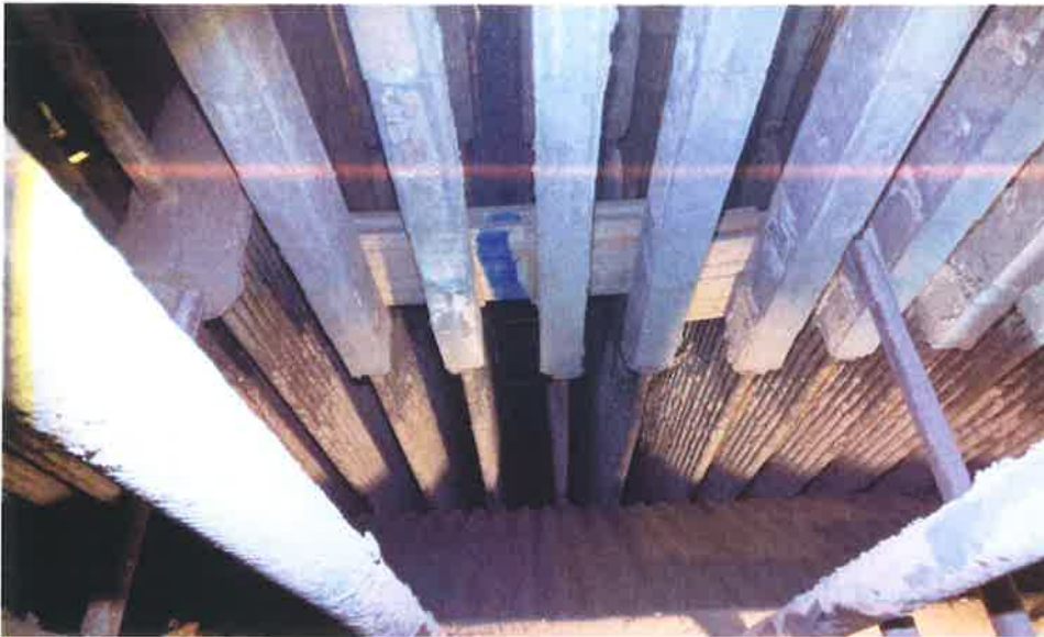
Závěsné trubky přehříváku jsou chráněny vyzdívkou
