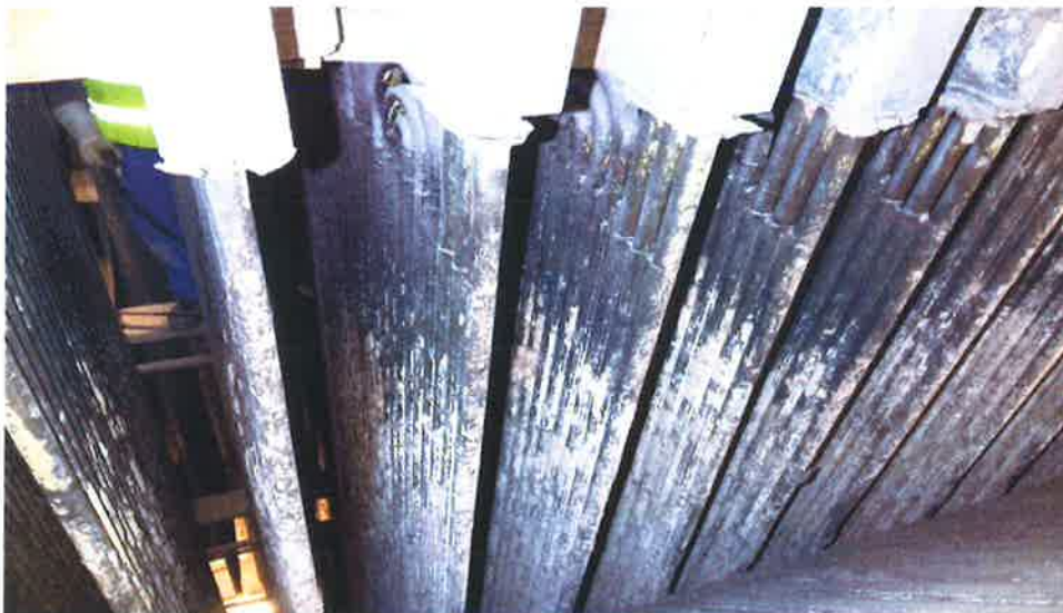
Hady přehříváku s inconelovým návarem
