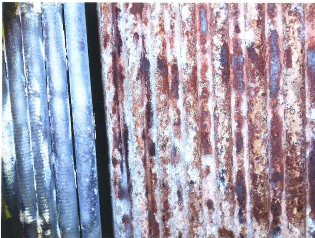
Inconelem chráněné trubky přehříváku v kontrastu s nechráněnou plochou membránové stěny
