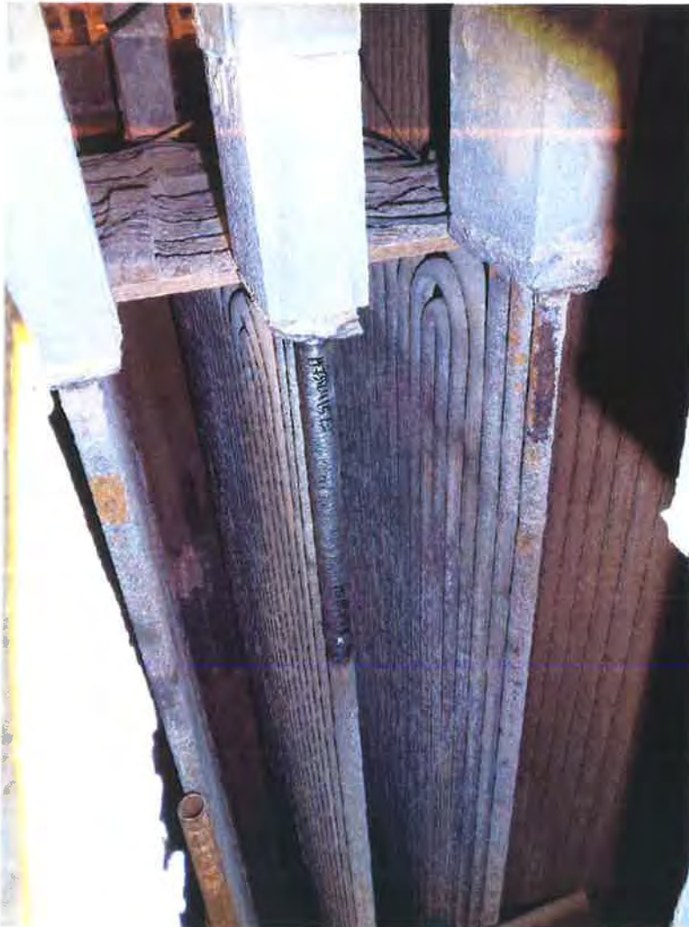
Hady přehříváku s inconelovým návarem – zde již s částí vyměněné trubky přehříváku na náběžné straně spalín.
