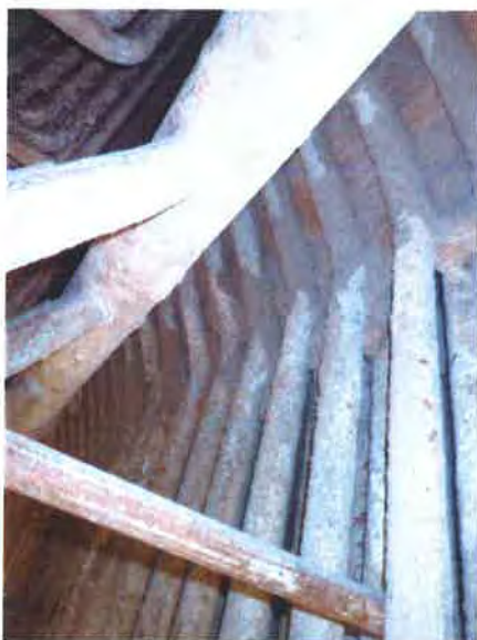
Obr. 1.2-4 – Trubky trubkového svazku P4100195 –
