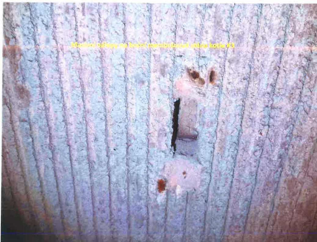
Boční membránová stěna 2. tahu kotle K3 s masivními nálepy.
