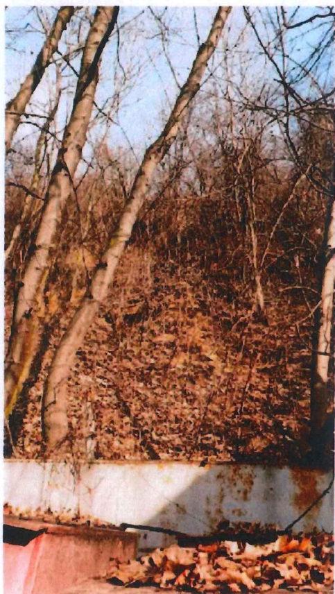
Obrázek 14: Pohled na povahu svahu a depresního kužele nad nejvíce postiženou částí zdi a oplocení, svah je hustě kryt vegetačními zbytky, náletem a křovinatou vegetací
