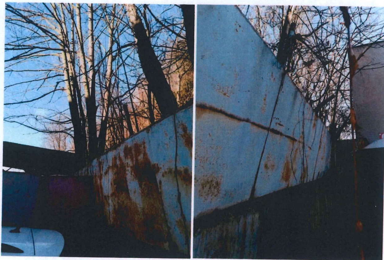
Obrázek 12: Pohled na míru vyklonění narušení zdi s vlivem zatížení od vzrostlých stromů
