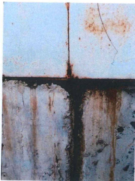
Obrázek 11: Masivní narušení zdi podél svislého sloupku oplocení
