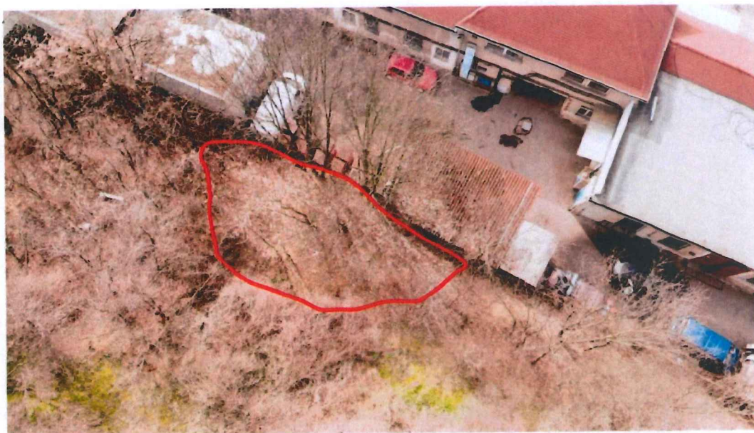
Obrázek 5: Horní pohled na hlavní poruchu svahu s povrchoým erozním kuželem a výrazným vzrůstem stromů a náletové vegetace
