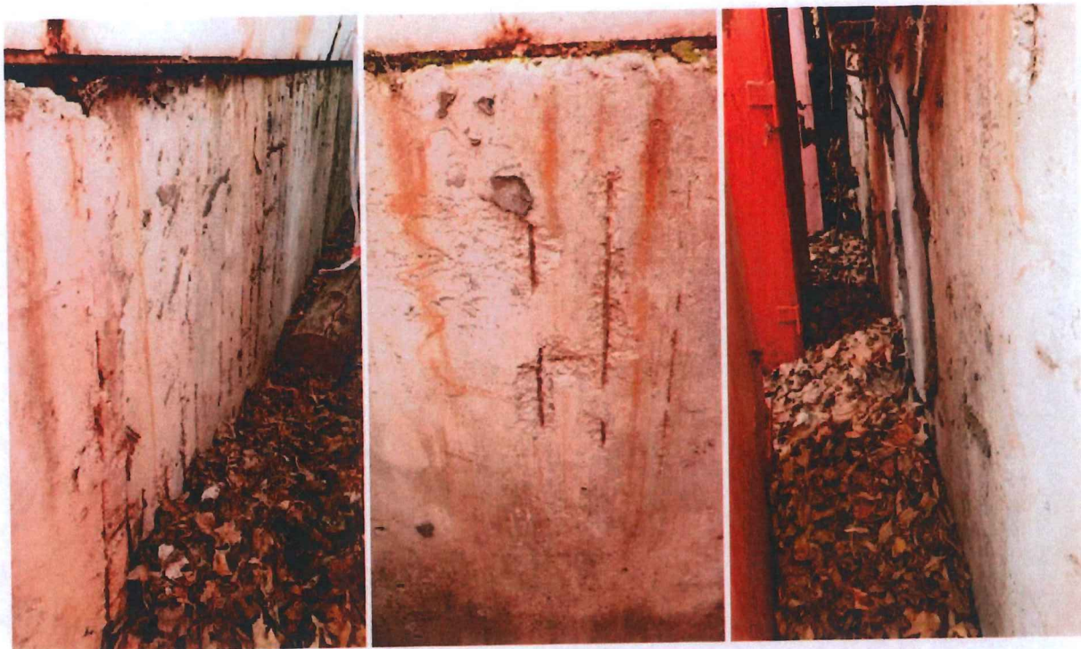
Obrázek 10: dílčí pohledy na narušení betonové zdi, vnější narušení karbonatací a korozi výztuže, narušení v pracovních / dilatačních spárách vykloněním, povrchová degradace dřívku zdi
