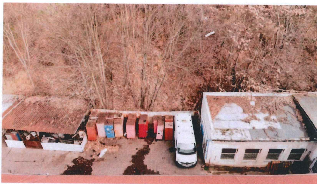
Obrázek 4: Pohled na hlavní místo narušení stability zárubní zdi, viditelné výrony vody z paty svahu přes dřík zdi
